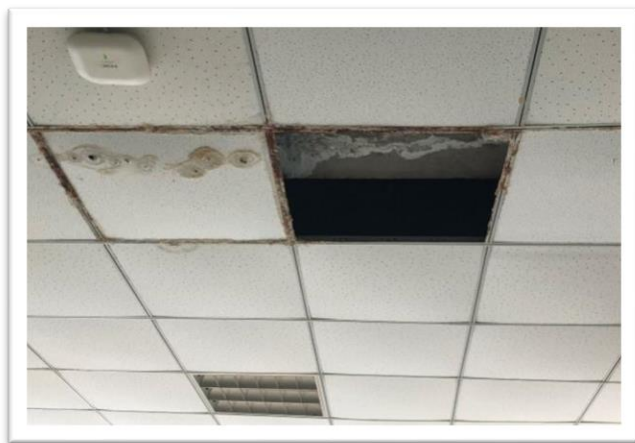
阎教楼 5 楼西南处走廊天花板漏水
